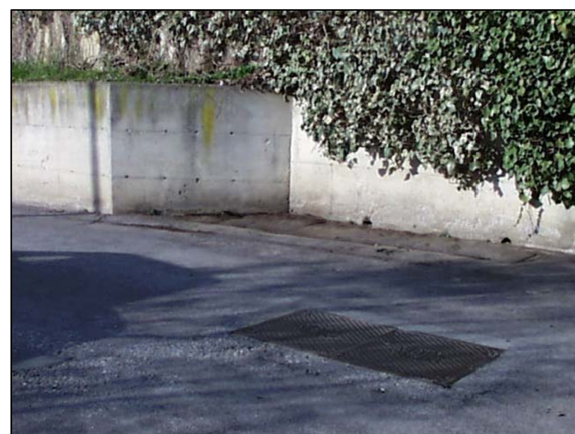
12 POZZETTO TELECON SULLA STRADA
